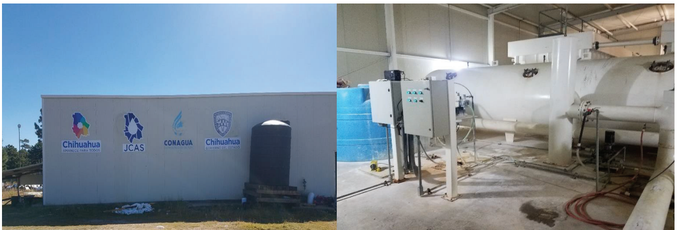
Planta potabilizadora de agua de la presa Situriachi
